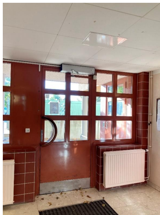
I gårdsentréerna är hela partierna rödmålade. Klinkerklädda bröstningar och smyggar. Vitt kablage till dörrstängare kan målas rött.
