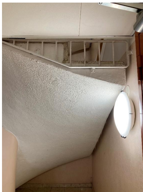
Trapploppens undersida har grov puts. Litet räcke på källarplanet som i vissa trapphus målats grönt som på översta våningen.
